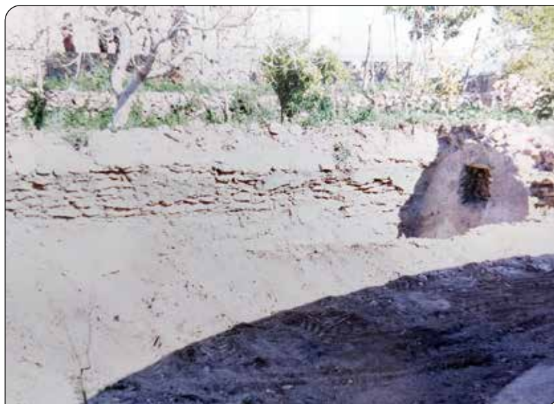
Aljibe de la finca “Los Frailes” destronado a finales del siglo pasado por los peligros de su derrumbe.
