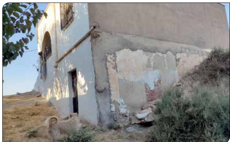
Cortijo, junto a la era de Los Frailes, en cuyos bajos se encuentra el aljibe, donde se observan las tuberías de entrada del agua y el grifo de salida para uno de los cortijos.
