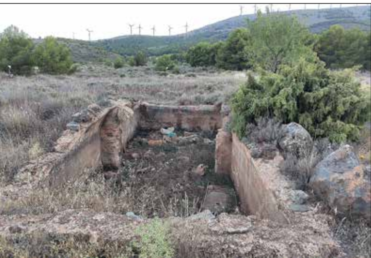
Aljibe de los Giles, actualmente en estado ruinoso.
