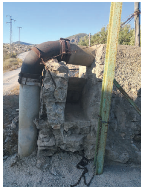
Cauce de acequia demolido en El Palomar.
